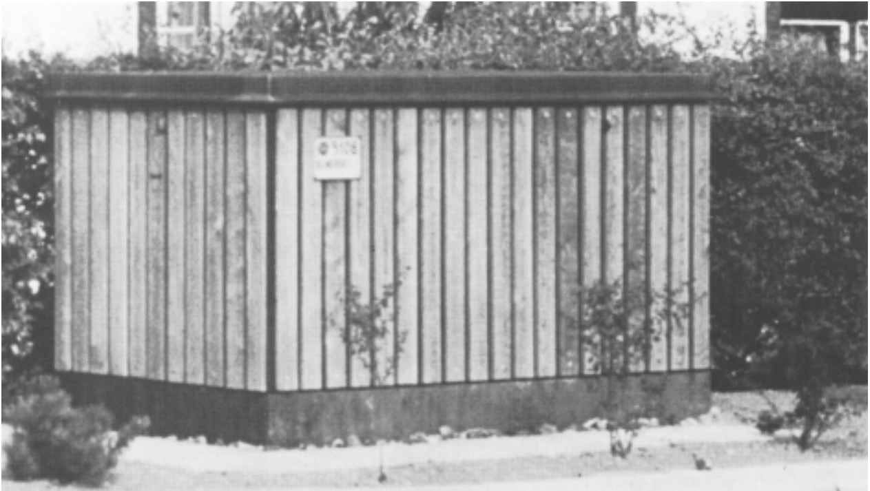
Fig. 10. Kabelforsynet transformerstation 10-20 kV.
